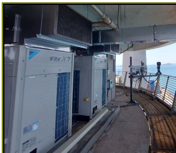
葵涌海上交通控制站空气调节机组
