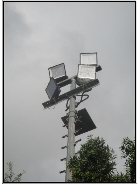
设于西区装卸区 具能源效益的发光二极管灯
