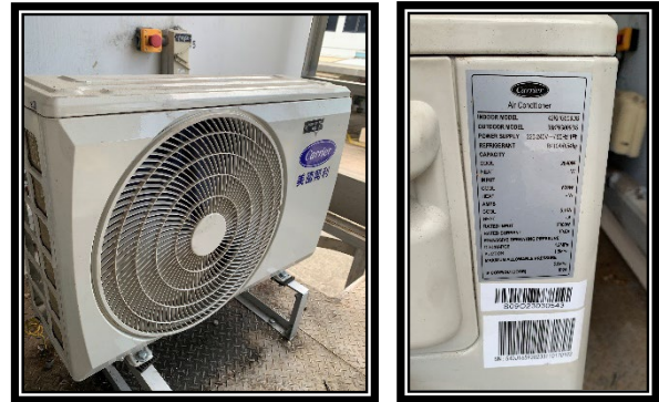
新更换的变频式空调机组
